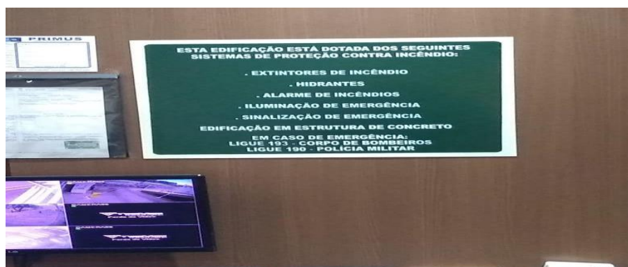
Figura 28 - Placa de itens de combate incêndio
