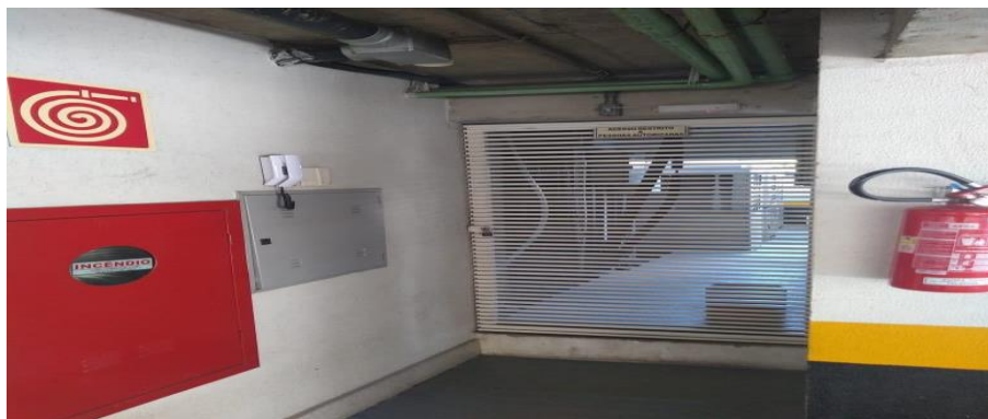
Figura 30 - Entrada para o sistema de ar condicionado
