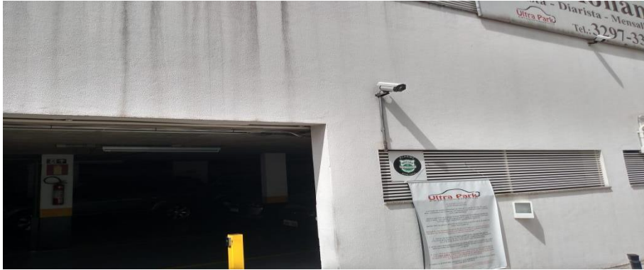
Figura 22 - Câmera na entrada do estacionamento
